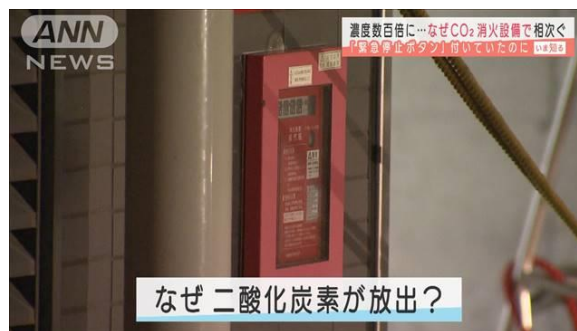
図.1 CO2消火設備の起動ボタン
